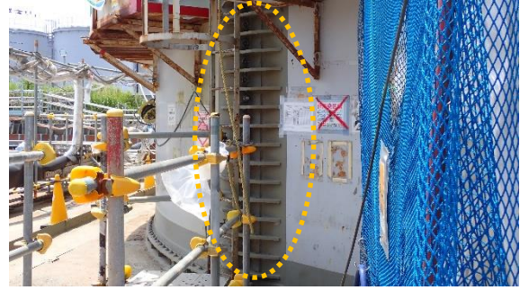
(写真2①) フランジ接続部分
