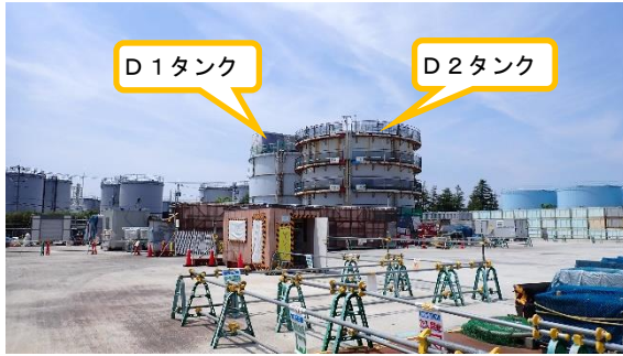
(写真1) フランジ型タンク外観
