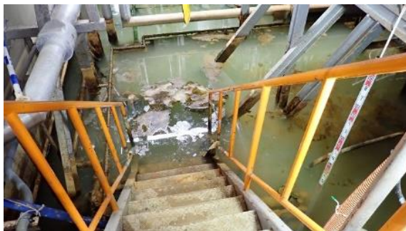
(写真1-1) 5号機タービン建屋地下階の滞留水の状況
