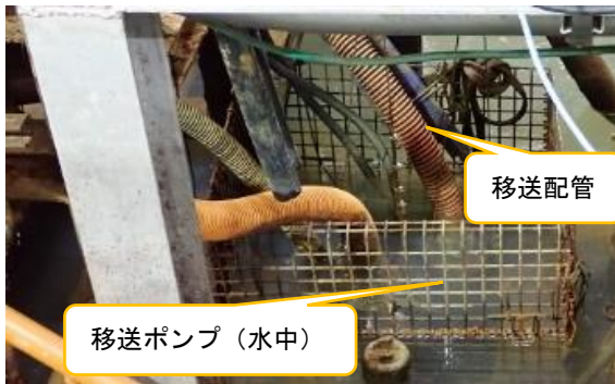
(写真 2-2) 6号機タービン建屋地下階滞留水移 送ポンプの状況
