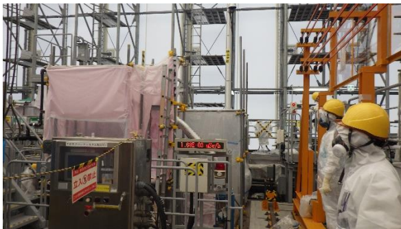
(写真5-1) 既設ALPS処理水設備・漏えい事象 への対応状況① 漏えいは、奥の白シートの下部 (1m×3m×1mm)と推定され、作業員ら が拭取り等を実施。
