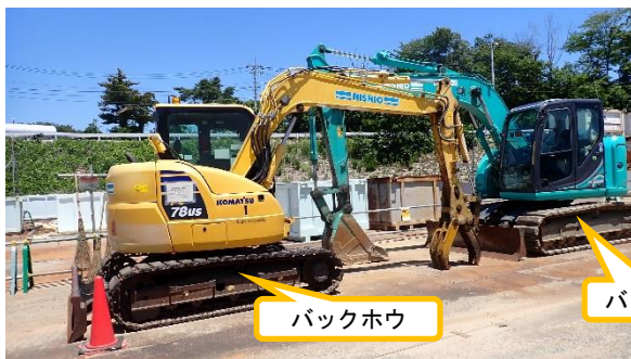
(写真1-2) 詰替え作業エリアで使用する重機 類（バックホウ2台） (南側から撮影)
