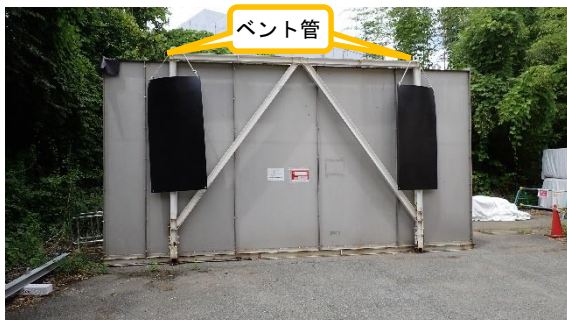
(写真1①) ベント管設置後の保管容器
