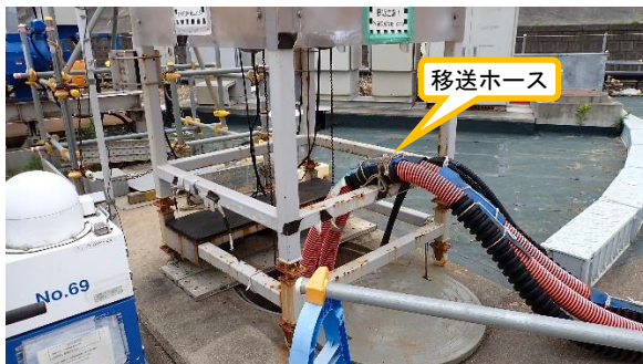
(写真 3 - 1) 移送ホースの設置状況 (K排水路からの汲み上げ)
