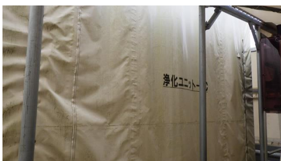
(写真1-2) 浄化ユニット外観②
