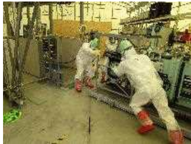
堆積物除去装置 (低圧水) 設置
