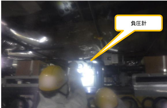
(写真4) 負圧維持確認の状況 (負圧計の値を確認している様子)
