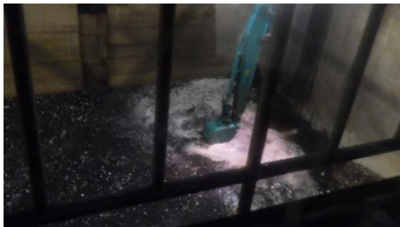
(写真2) ピット内の水・伐採木チップ回収作 業の状況 ※建屋内にあるクレーン操作室から 撮影
