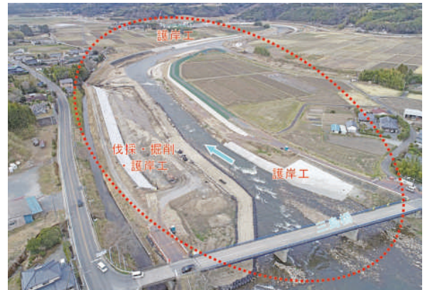
夏井川14工区（小川町三島瀬棚地内）掘削・護岸工を施工中
