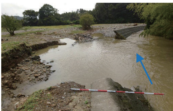
藤原川 河川堤防決壊（いわき市常磐藤原町）
