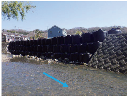
藤原川（常磐藤原町別所）被災状況
