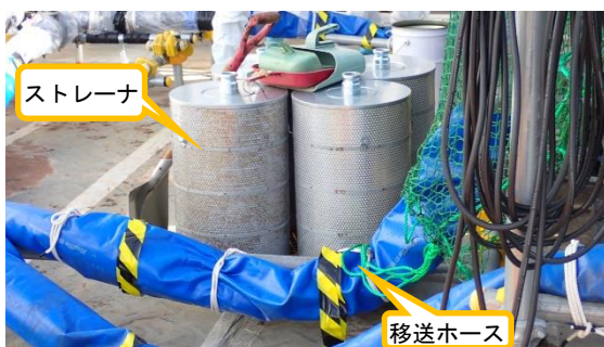
(写真1-6) 異物を除去するストレーナ
