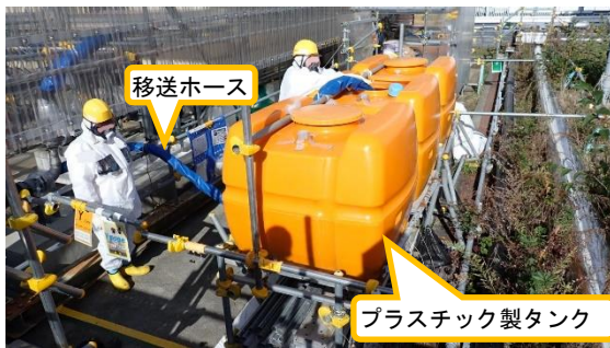
(写真1-4) プラスチック製タンクへの水の受け 入れ作業の実施状況
