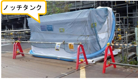
(写真3-2) 貫通孔西側に設置されたノッチタンク の状況 (北東側から撮影)
