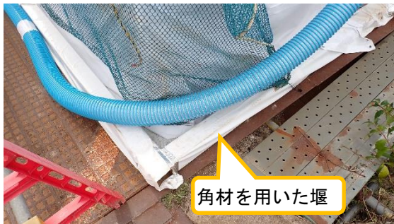
(写真4-2) 貫通孔西側ノッチタンクに設置され た堰の状況
