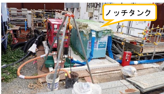
(写真3-1) 貫通孔東側に設置されたノッチタンク の状況 (北西側から撮影)
