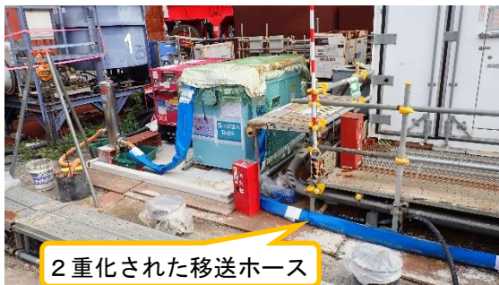
(写真4-3) ノッチタンク間の移送に使用される 移送ホースの2重化の状況
