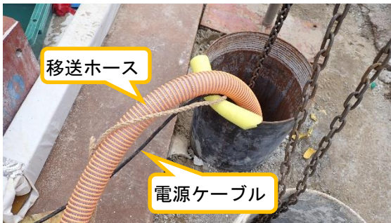
(写真2-1) ポンプ及び移送ホースが投入された 貫通孔の外側の状況
