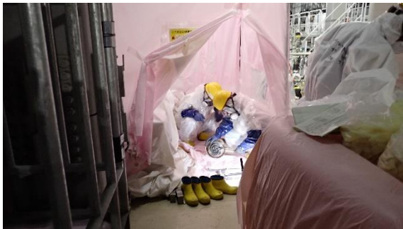
(写真 3 - 1) 排水移送ポンプの分解点検状況① ※除染エリアと同様、仮設ハウスを設置し、その中でポンプの分解点検を実施。
