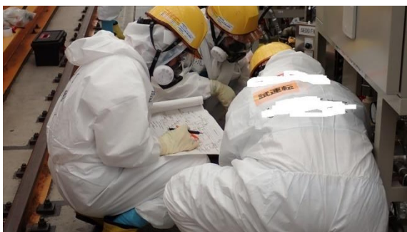
(写真2) スラリー抽出装置（SEDS）試運 転に向けた系統確認の状況
