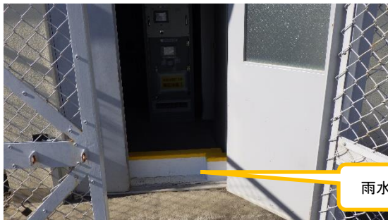
(写真 3) 雨水浸入防止のため、ドア入口部分 に防水堤(H=200mm)を設置。
