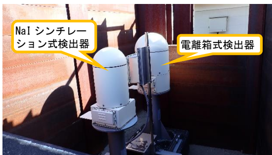
(写真2-1) 遮へい壁内側に設置された放射線 検出器
