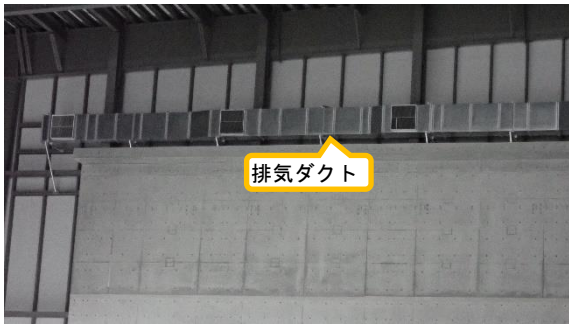
(写真 5 - 2) 建屋内南側における排気ダクトの設置状況② (拡大)
