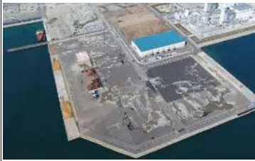
<3号埠頭液状化状況>
