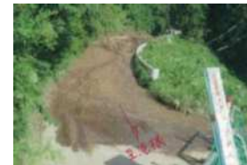
平成19年 法面前落による通行止めが発生
