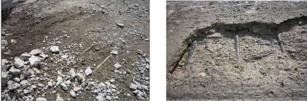
【写真 1】 舗装切削後に判明した床版の損傷状態
