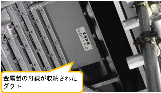
(写真 1 - 3) 作業用足場上部の金属製母線の状況 (拡大) (6号機タービン建屋地下1階)
