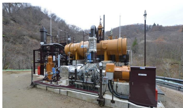
土湯温泉16号源泉バイナリー発電所（福島市）
