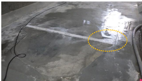
(写真1①) 防水塗装下部への浸水
