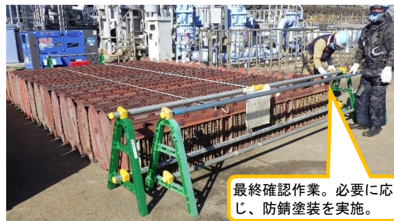
(写真3①) 点検・清掃後のスクリーン
