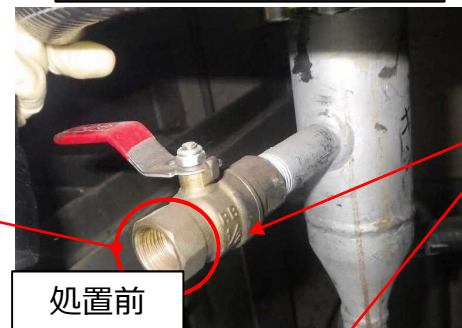
ベント弁の現場状況
