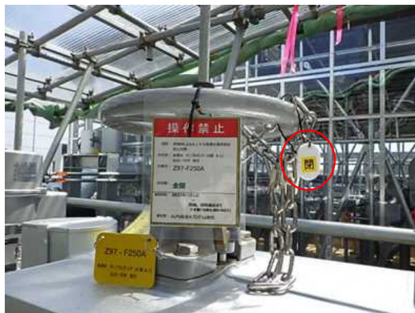
作業中における弁の開閉状態表示
