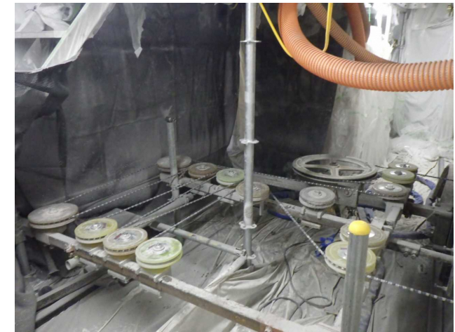
< 2号機燃料取り出し用構台前室内遠隔操作装置 >
