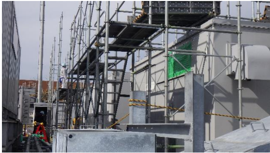
(写真 1-2) 現在増設工事が実施されている共用 ディーゼル発電機 B 系の工事実施状 況
