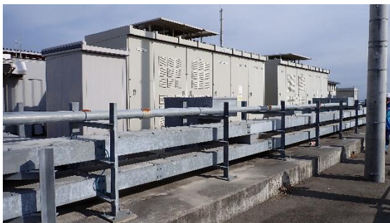
(写真 2) 窒素ガス分離装置 A 及び B と共用ディ ーゼル発電機 A 系の設置状況
