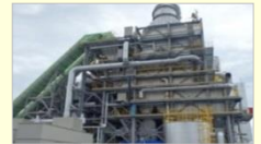
仮設焼却施設
