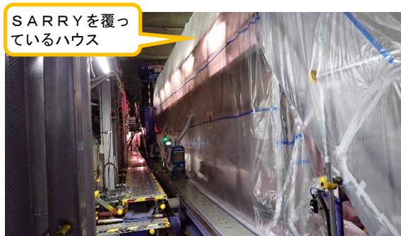
(写真1-2) SARRYを覆っているハウスの設置状況② (建屋内西側)
