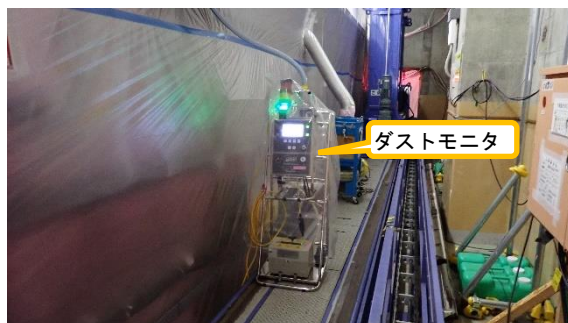
(写真2-2) ハウス外側に設置されたダストモニタ (建屋内東側)
