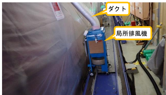
(写真2-1) ハウス外側に設置された局所排風機 (建屋内東側)
