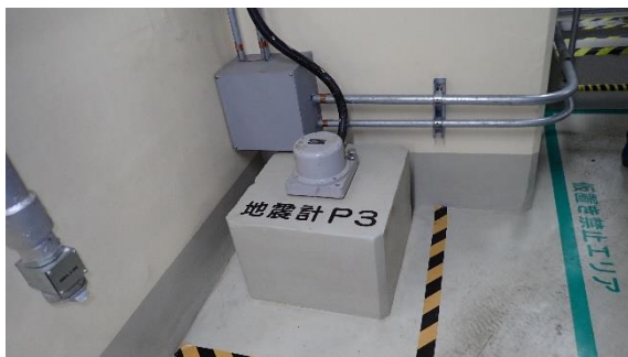
（写真 1 - 1） 地震計の設置状況① （令和 5 年 6 月 5 日撮影）
