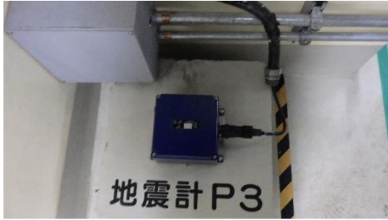
(写真 2) 地震計の設置状況③
