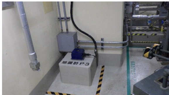
（写真 1 - 2） 地震計の設置状況② （令和 7 年 3 月 1 0 日撮影）
