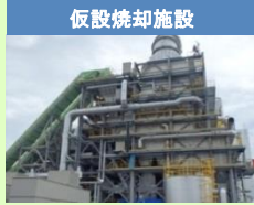
仮設焼却施設
