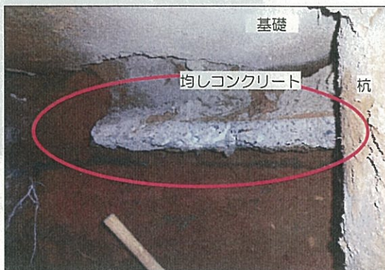
崩落前の状況
