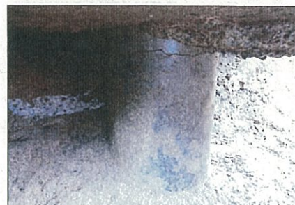
当該杭の状況
