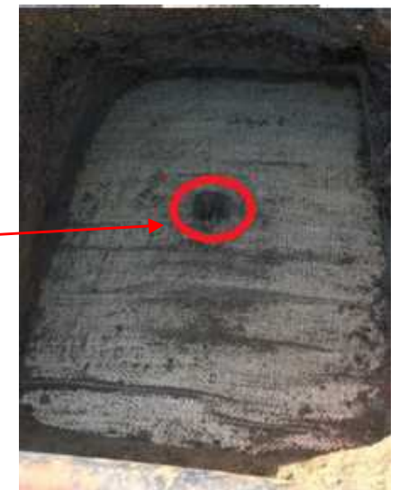
【法面遮水シート損傷部】
