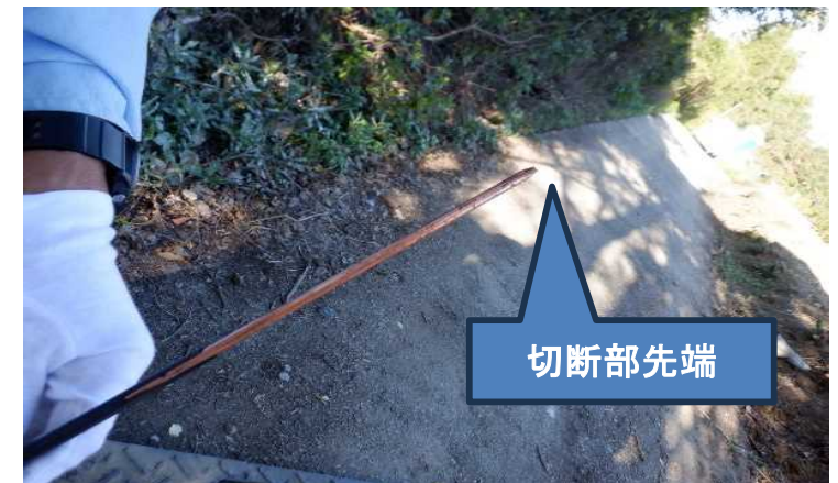
【切断された架空線】
