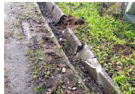
【破損した側溝】
