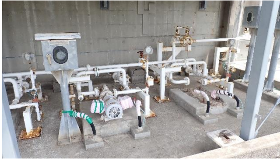
(写真3) No. 3 軽油タンク南側のD/G移送 ポンプ設備の状況 ※ 各設備（D/G燃料移送ポンプ 等）の点検作業が実施されていた
