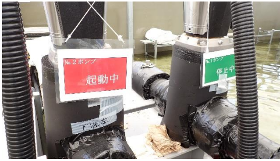
(写真 1－1) 移送ポンプの設置状況 ※No. 1：停止、No. 2：運転
