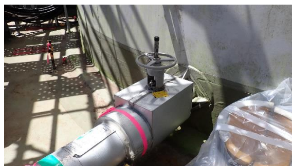
(写真5①) 出口弁の状況
