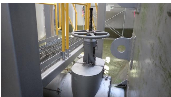
(写真5④) 連結弁の状況
