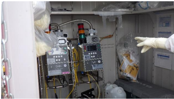
(写真 3) ダストモニタ設置状況
