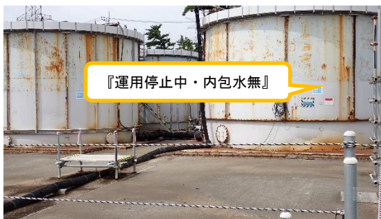
(写真2) フランジ型タンク残置の状況 ※特にフランジ部に錆が目立つ
