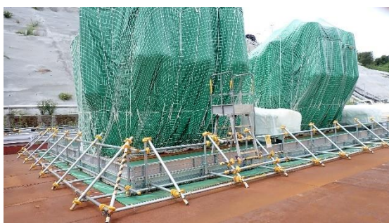
(写真3) 起動変圧器の仮置き状況
