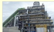
仮設焼却施設
