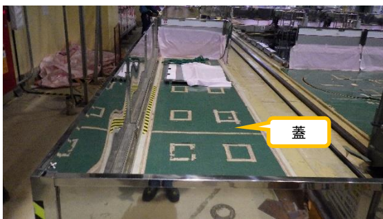
(写真5) 5号機新燃料貯蔵庫の状況
