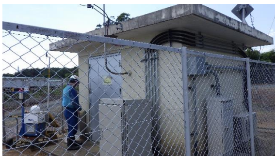
(写真5-3)モニタリングポストNo. 2の 状況
