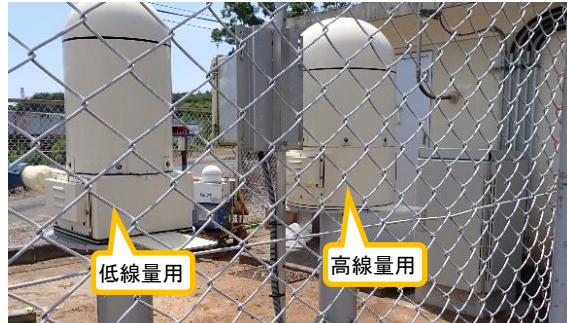
(写真5-4)モニタリングポストNo. 2の 空間線量測定器
