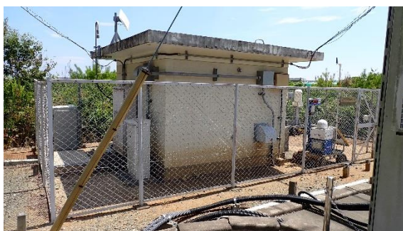
(写真5-1)モニタリングポストNo. 1の 状況
