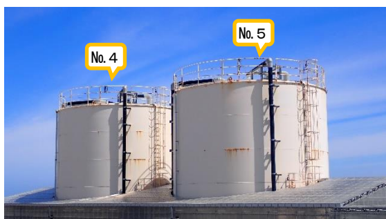
(写真 1 ①) 集水タンクNo.4及び5
