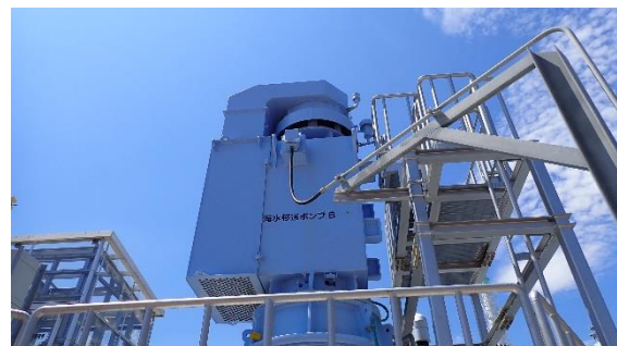
(写真 3) 海水移送ポンプの状況
