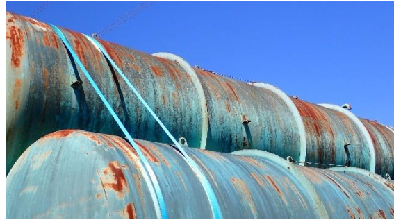
(写真8) ブルータンク頂上部の錆 の状況
