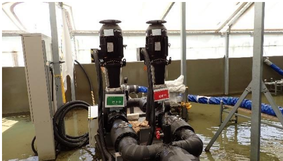
(写真1-2) 移送ポンプの設置状況
