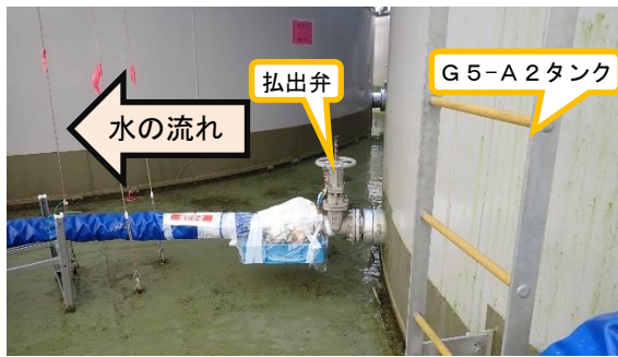
(写真1-1) ALPS処理水の移送状況 ※払出弁から移送ポンプへ
