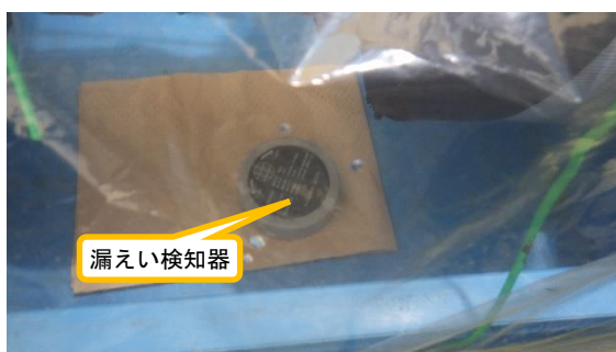
(写真2-2) 漏えい検知器の設置状況
