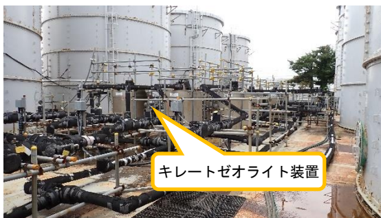
(写真 5 - 1) 旧処理設備キレートゼオライト装置 状況①
