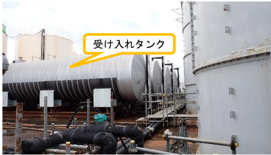
(写真 3) 旧処理設備受け入れタンクの状況
