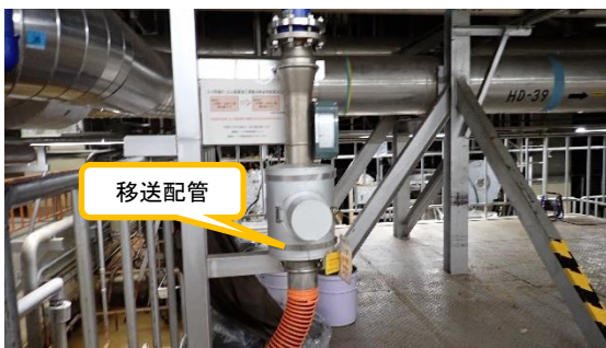
(写真 2－1) 滞留水移送配管の状況① ※5号機タービン建屋→6号機ター ビン建屋
