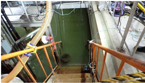
(写真 1－2) 6号機タービン建屋滞留水の状況
