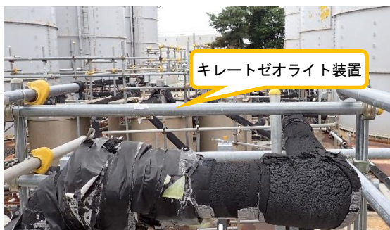
(写真 5 - 2) 旧処理設備キレートゼオライト装置 状況②
