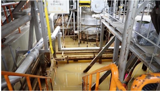
(写真 1－1) 5号機タービン建屋滞留水の状況
