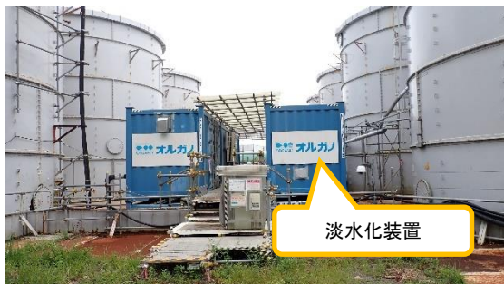
(写真6) 旧処理設備淡水化装置の状況
