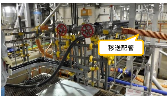
(写真 2－2) 滞留水移送配管の状況② ※6号機タービン建屋→F 1 タンク エリア
