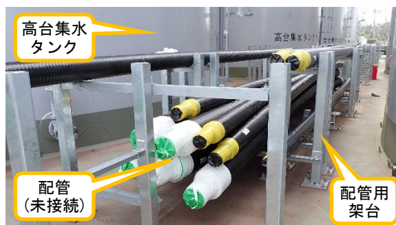
(写真 2-2) 未接続の配管の保管状況
