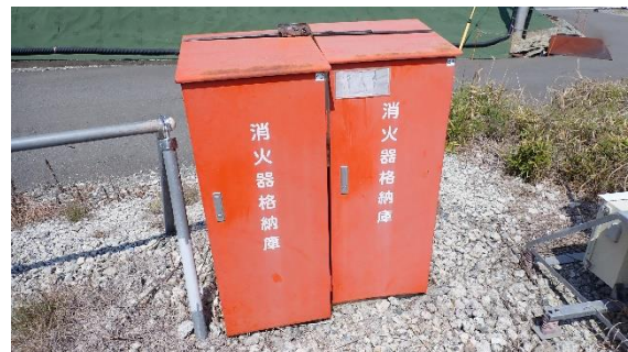
(写真 2 ③) 消火器の設置状況
