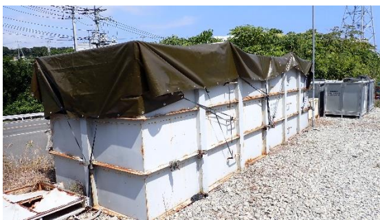
(写真 2 ②) 消火用タンクの設置状況
