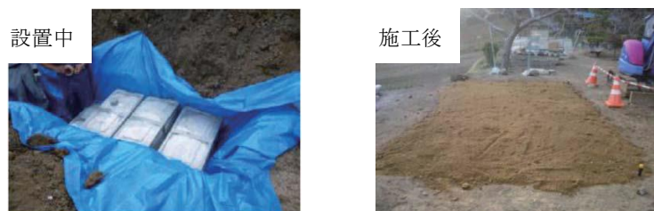
図 4-2 現場保管（地下保管）の例
