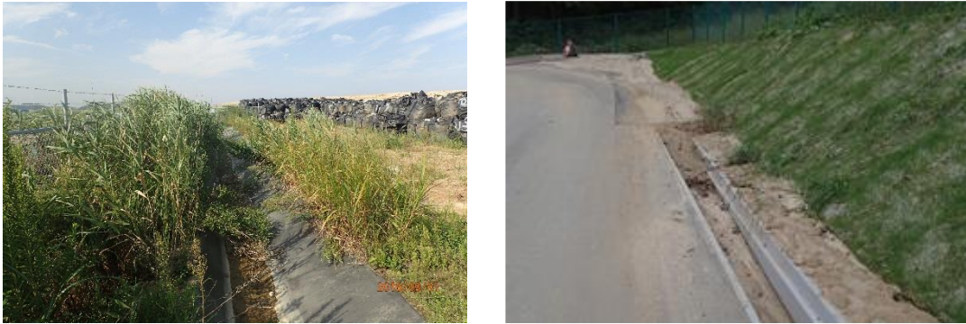
図 3-6 雨水排水設備に土砂が堆積した例
