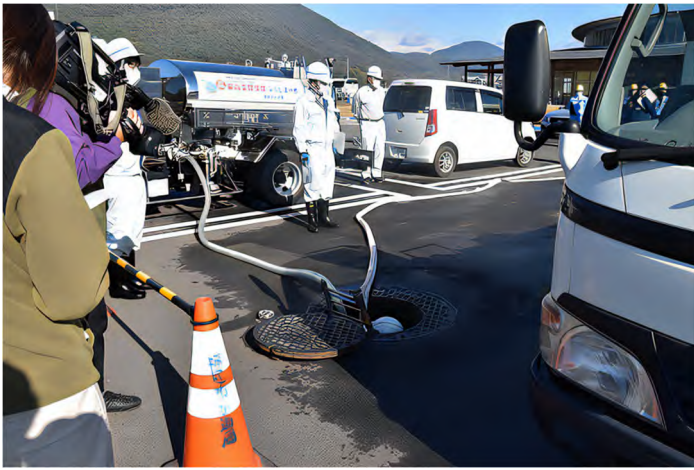
③ 道の駅ふくしまの地下タンク
