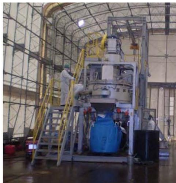
図 2-1 実証試験におけるセメント固型化施設
