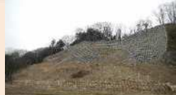
山腹崩壊地(白河市)
