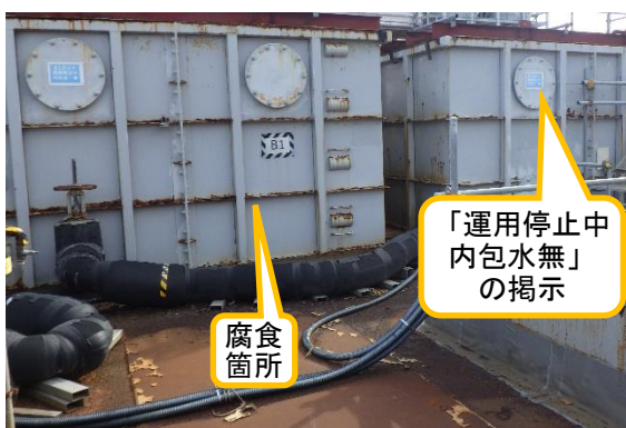
(写真1) F2タンクエリアB群のタンク（フランジ型タンク）の外観
